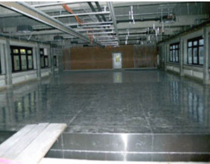
Die großflächige Abschirmung eines Bürogebäudes gegen eine darunterliegende Trafostation mit Aaronia MagnoShield® Abschirmplatten
